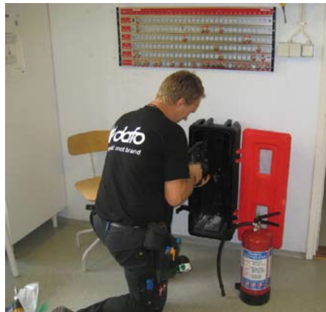
Nya pulversläckare har monterats i de flesta tvättstugorna i Brf Svartvik. Monteringsarbeten fortsätter under hösten.
