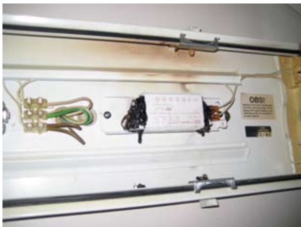
Lysrör som brunnit.
